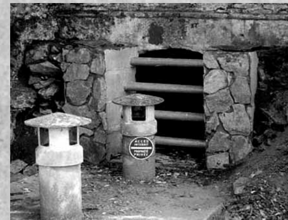
Grille interdisant l'accès d'une galerie d'Ersa mais autorisant le passage des chauves-souris
